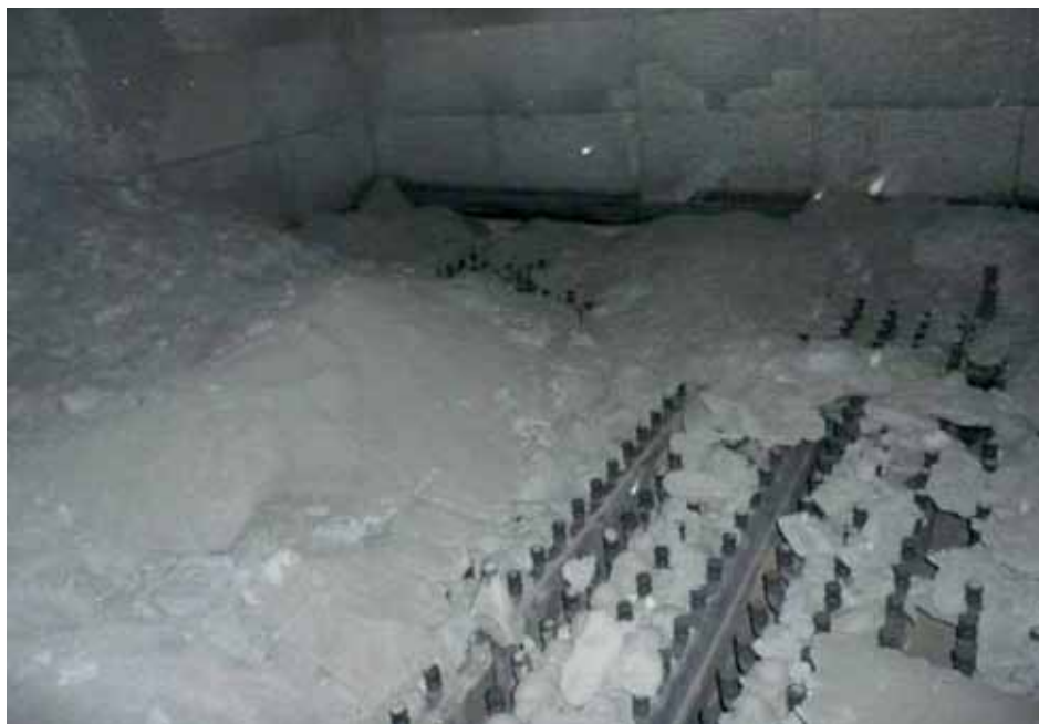
Rycina 6. „Zablokowanie” złoża szlaką z powierzchni ogrzewalnych kotła
